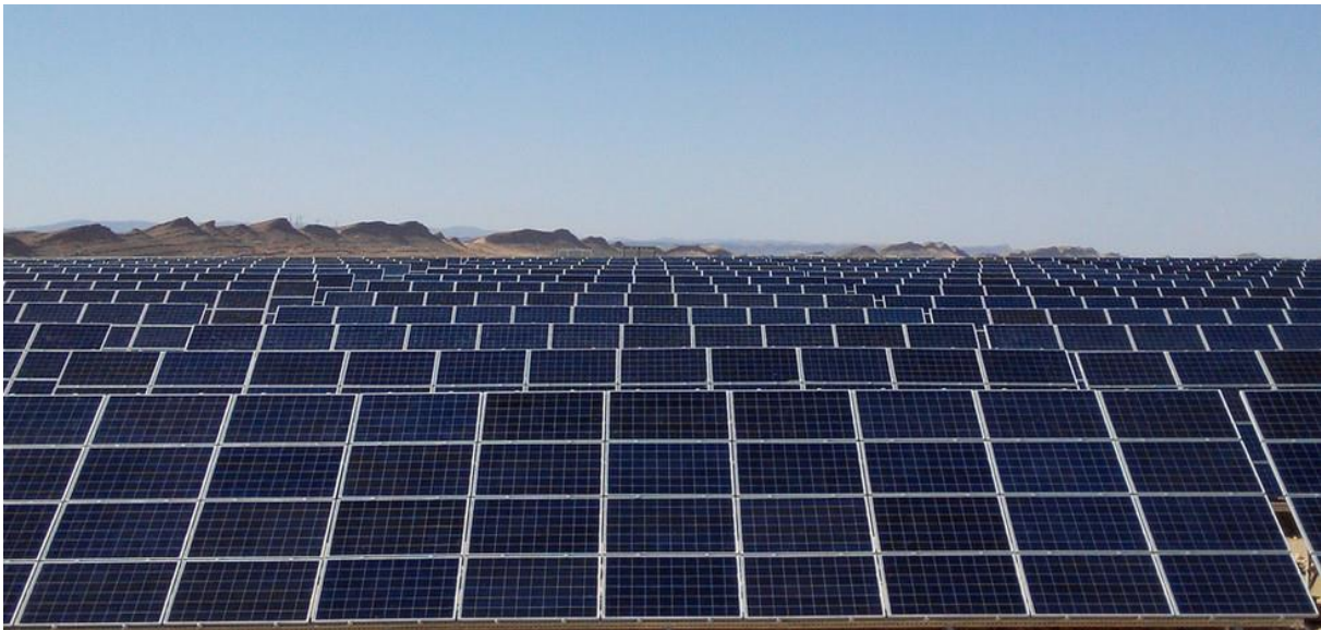
Figure3.1 : station solaire photovoltaïque d'El Kheneg wilaya de Laghouat
