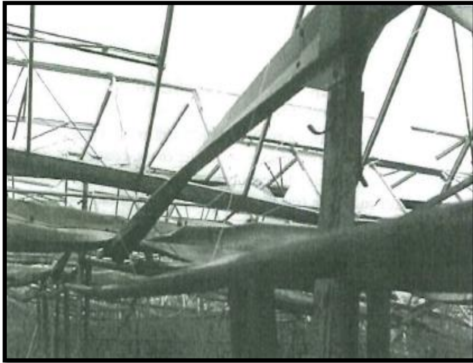
Figure .I.7.Effondrement des poutres de portique par le déversement.
