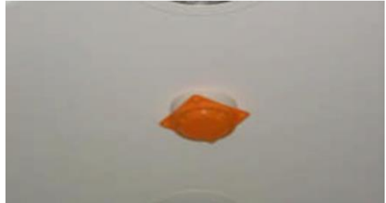
Figure 143:Eclairage de sécurité.Source: http://ww2.ac-poitiers.fr
