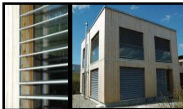
Figure I. 65 : store électrique utilisé dans la maison, source : http://lab-immo.ch/1037/ Minergie-P-ECO MAISON
