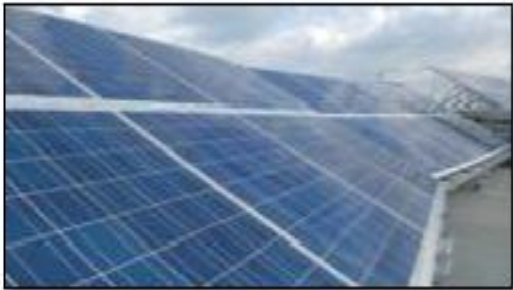
Figure I.34 : photo de panneau photo voltaïque source : http://www.reseau-breton-batiment-durable.fr/retour_experience/residence-salvatierra
