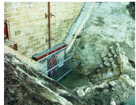
Fig I. 61: Travaux lors de la visite décennale Source : L'eau richesse de Caromb, PDF.
