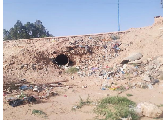
Fig.III. 33 : Les déchets et la conduite d'assainissement dans le lit de l'Oued M'ZI
