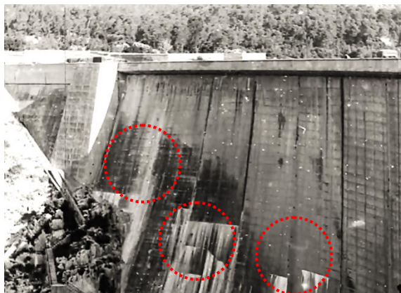
Fig I. 49: Les fissures apparus dans le barrage de Bimont
