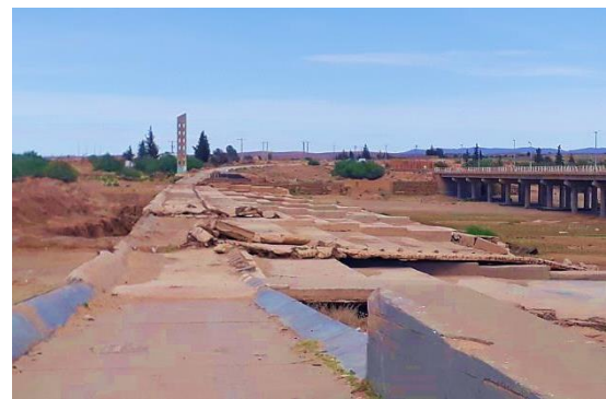
Fig.III. 8 : Vue générale sur la partie supérieure endommagée du barrage
