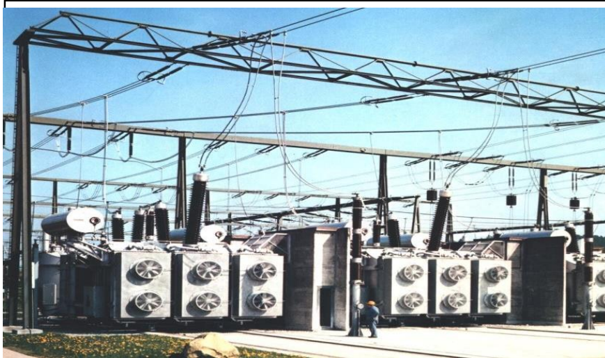
Figure I.18 Transformateur d'interconnexion de réseau
