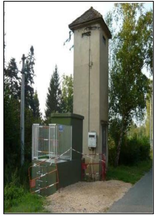
Figure I.20 Poste de distribution Cabiné
