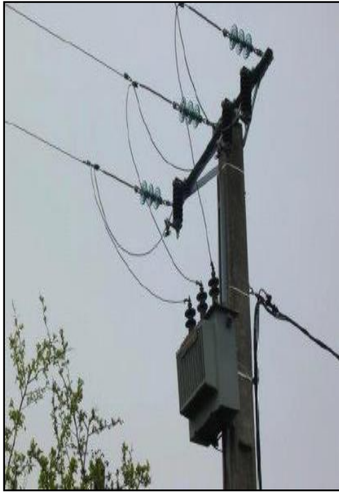
Figure I.19 Poste de distribution sur poteaux
