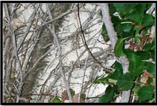
شكل 4-19- الجذور المتسلقة التي تلتصق بالجدار يمكن أن تتلف سطح الجدار المصدر: Sam C. M. Hui, Benefits and potential of vertical greening systems, 2011, Department of Mechanical Engineering, The University of Hong
