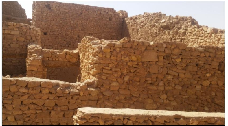
Figure 4: la dégradation des murs source : auteure
