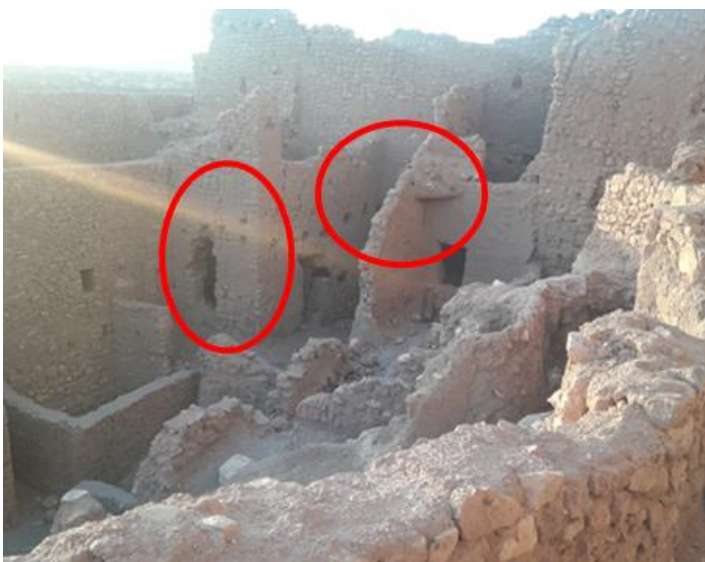
Figure 7 : l'effondrement des murs/des fissures ponctuelles source : auteur
