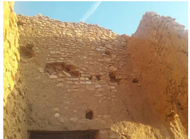
Figure 62: des fissures superficielles source : auteures
