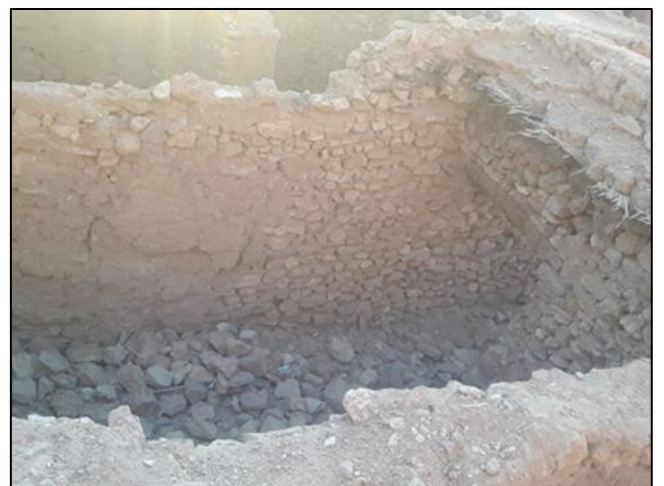
Figure 13 : l'effondrement des planchers source : auteure
