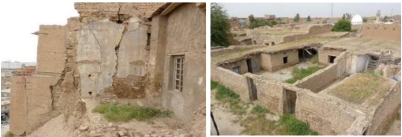
Figure 20: l'état de la citadelle source : conservation of Erbil citadel ,Iraq
