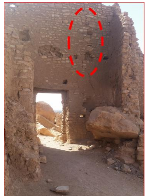
Figure 8 : des fissurations structurelles source : auteur
