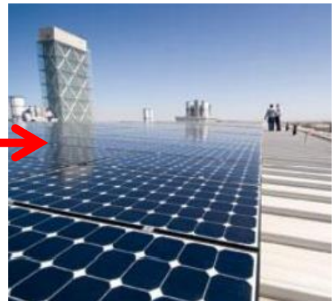
Figure 123 : panneaux photovoltaïques Source : www.carboun.com
