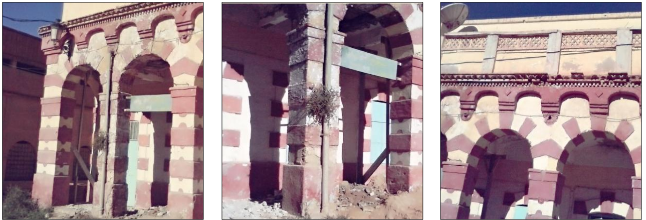
Figure 98-99-100 CH III: les pathologies de la façade est de la place de l'étoile (prise par les étudiantes)
