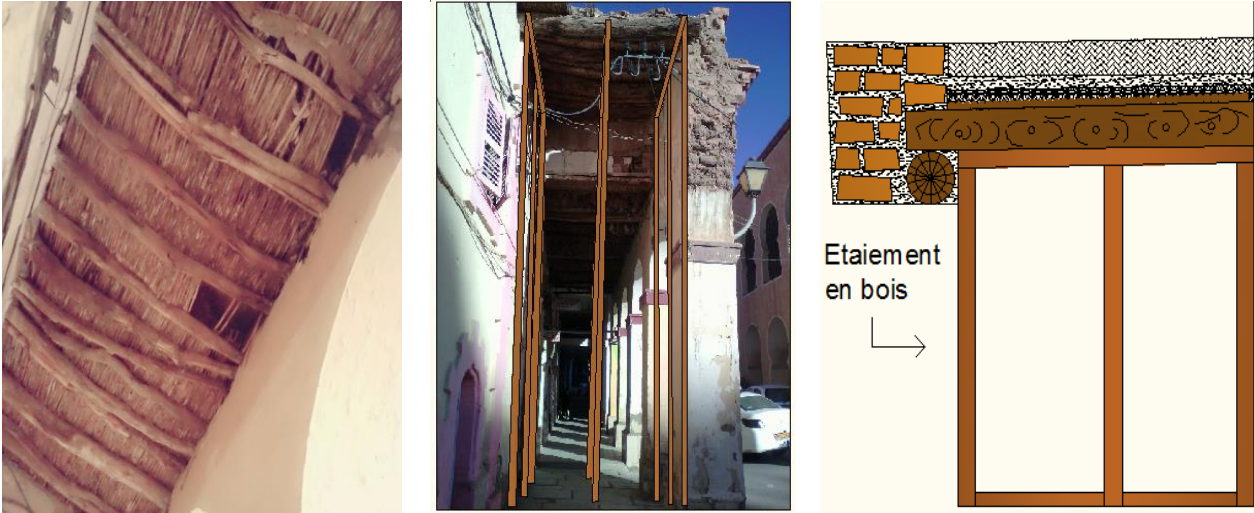
Figure150 III : plancher en bois dégradée élaborer par les étudiantes
