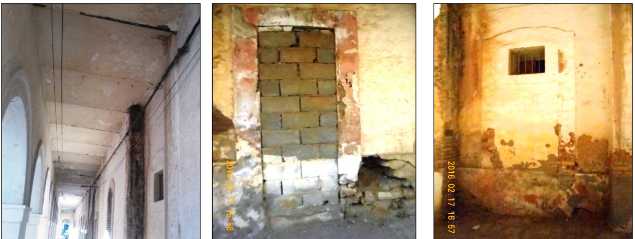
Figure 110-111-112 CH III: les pathologies de bureau de génie militaire de la place Randon (prise par les étudiantes)
