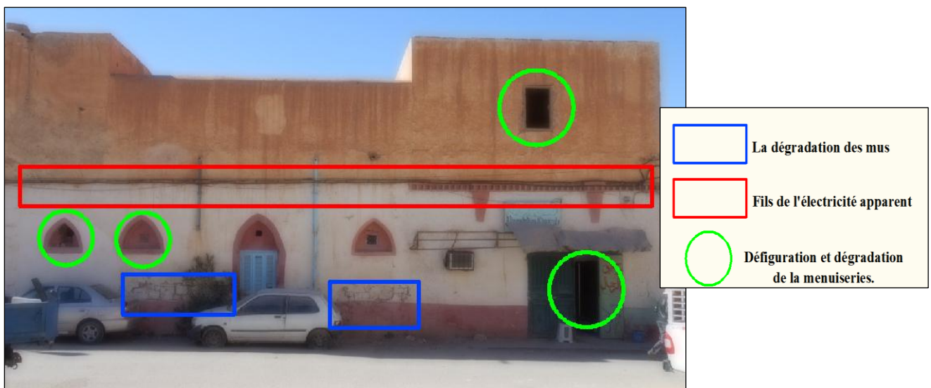
Figure 96 CH III: les pathologies de la façade sud de la place de l'étoile (Prise par les étudiantes).
