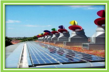
Figure 21: L'intégration des panneaux photovoltaïques
