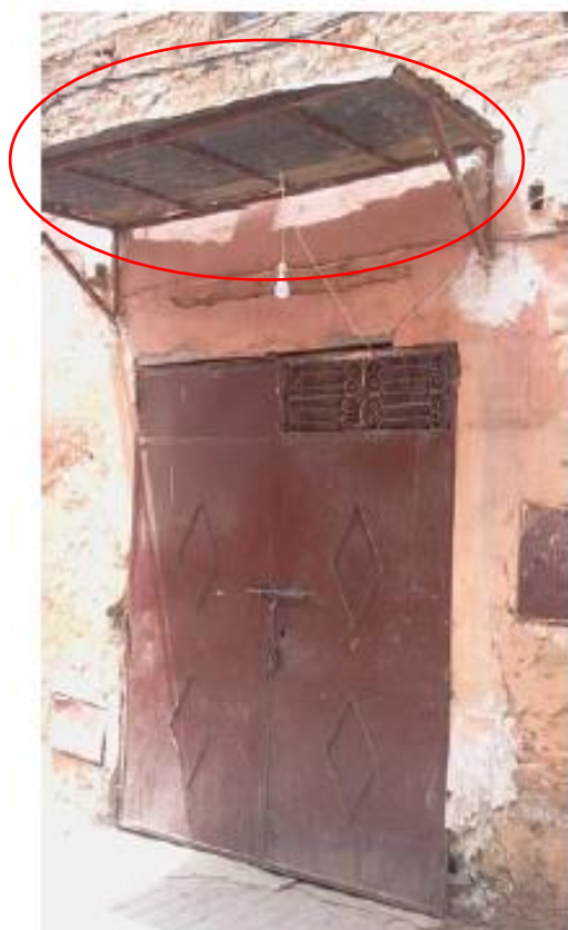
Auvents métalliques inesthétiques
