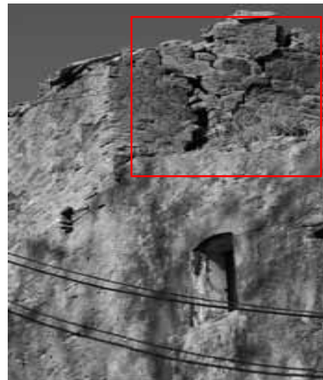
Figure 41 : Dommage dû aux poussées transmises par la couverture Source : PDF manuel pour la réhabilitations de ville de Dellys
