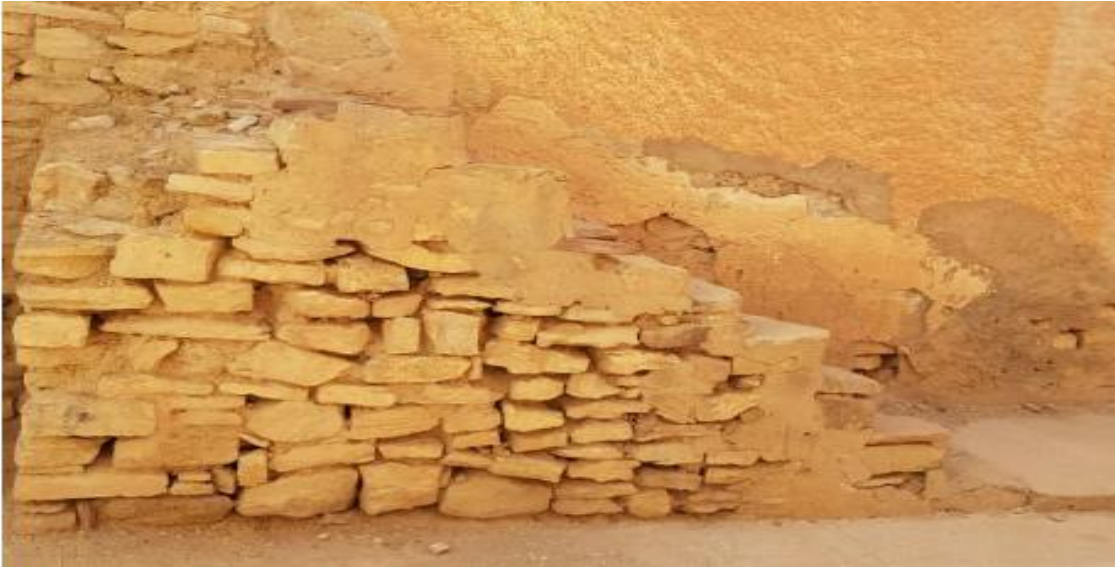
Figure 144 : des escaliers endommagés dans la façade
