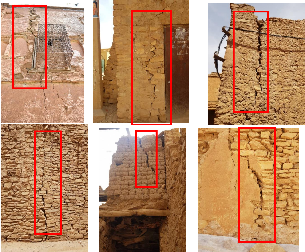
Figure 119:fissures profondes Source : auteur
