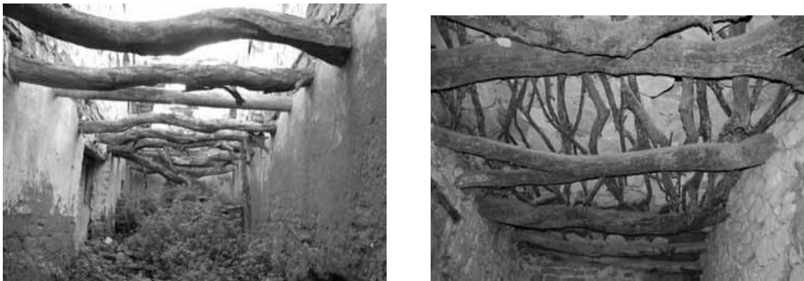
Figure 38 : plancher traditionnel casbah de Dellys Source : PDF manuel pour la réhabilitation de Dellys. Montada
