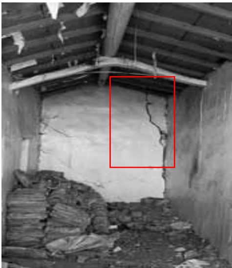
Figure 40 : Dommage dû à l'affaissement des fondations. Source : PDF manuel pour la réhabilitations de ville de Dellys
