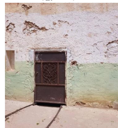
Figure 129 : une porte métallique incompatible
