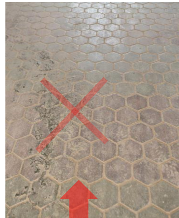
Figure 126 : Pave dégradé et non adapté esthétiquement
