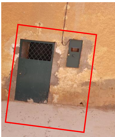
Figure 131 : une porte métallique incompatible
