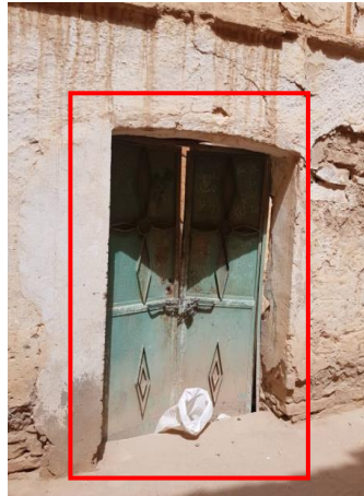
Figure 127 : une porte métallique incompatible
