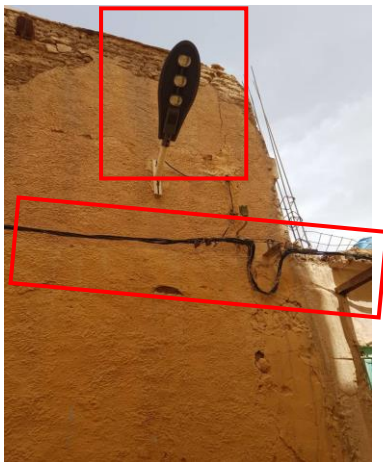
Figure 132 : installation électrique apparente
