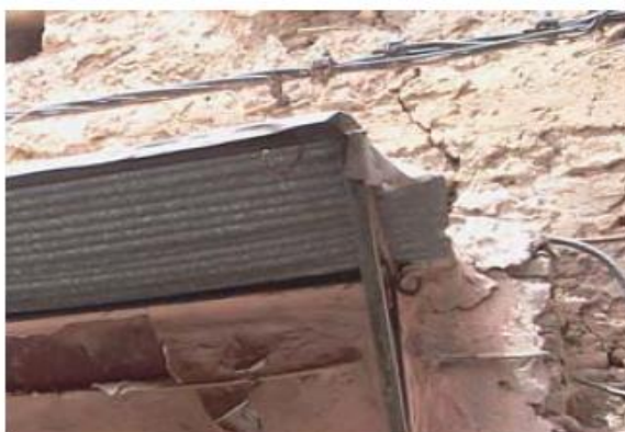
Fissures et décollement de l'enduit
