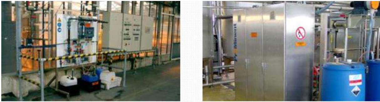
Figure I.4.5 : Installations au dioxyde de chlore dans le traitement de l'eau
