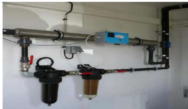
Figure I.4.21 : Installation de désinfection par UV
