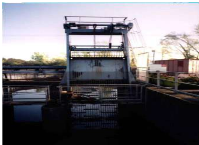
Figure I.2.7 : Les grilles mécaniques
