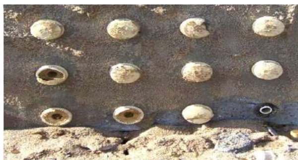
Figure I.3.54 : Busettes PVC détériorées
