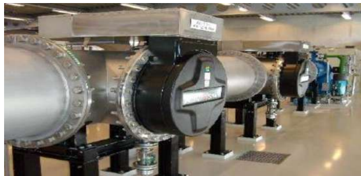
Figure I.4.19 : Installation de traitement UV de Trojan Technologies Europe pour la ville de Rotterdam . Les 24 réacteurs (2 x12) UV Swift peuvent traiter 16'000 m 3 /h.
