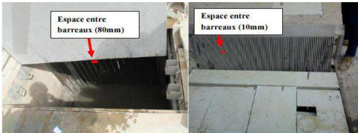
Photo2. Le dégrilleur moyen
