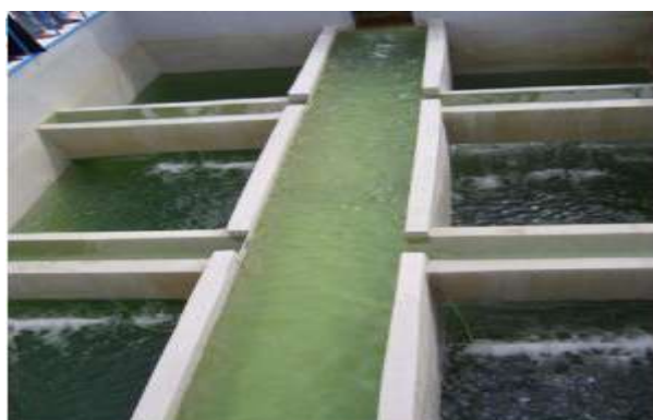
Figure I.3.50 : filtres à sable rapides (écoulement gravitaire) station de Sikkak.
