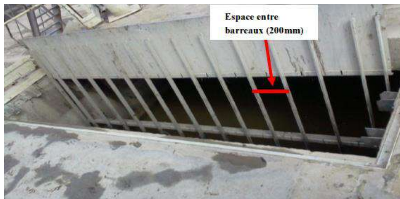
Figure I.2.2 : Le pré-dégrilleur à l'entrée de la STEP
