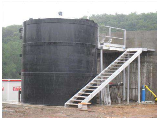
Figure II.5.4 : silos à boues
