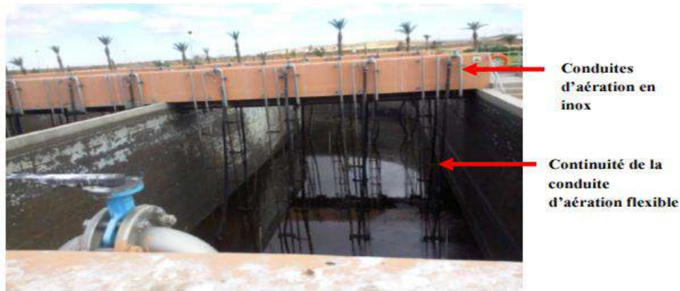
Figure II.3.24 : Le bassin d'aération vide
