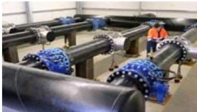
Figure I.4.18 : Système de désinfection par rayon UV , installé dans une usine de traitement de l'eau en Allemagne. Chacune des quatre chambres désinfecte jusqu'à 1060 m 3 /h
