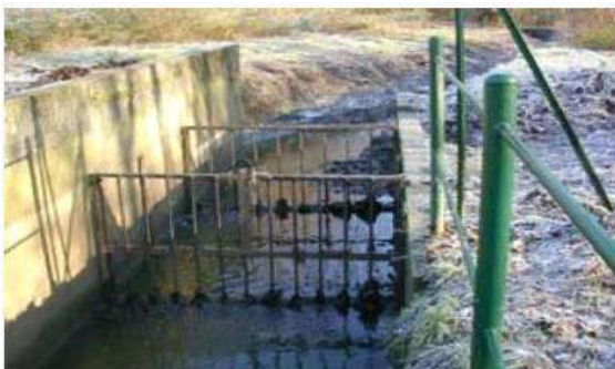
Figure I.2.4 : Dégrilleur destiné à retenir les objets flottants avant l'entrée d'un étang
