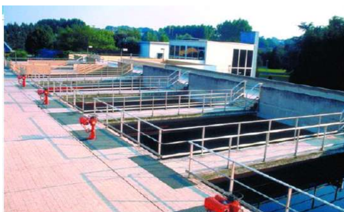
Figure I.3.63 : Installation de MOULLE (Pas-de-Calais) pour la Lyonnaise des Eaux. Débit: 2\,000\text{ m}^3 \cdot \text{h}^{-1} . Batterie de 7 filtres MÉDIAZUR V pour CAG.
