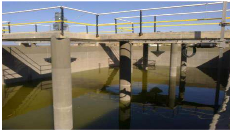
Figure II.3.22 : Bassin d'aération de la STEP de BOUZEDJAR
