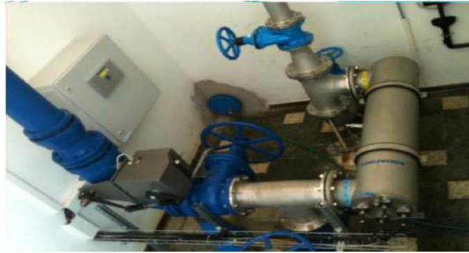
Figure I.4.20 : Installation de désinfection par UV
