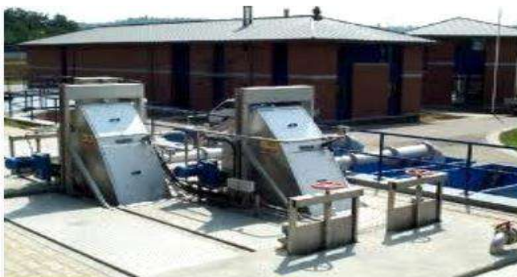
Figure I.2.8 : les dégrilleurs oscillants
