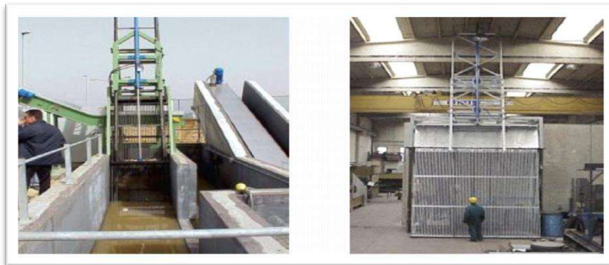
Figure II.2.5 : Dégrilleur verticale oleodynamique
