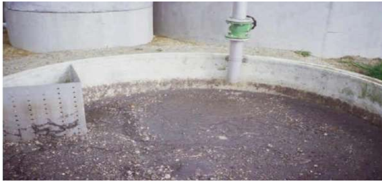
Figure I.2.14 : Extraction du sable d'un dessableur
