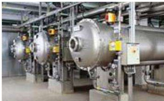
Figure I.4.11 : Générateurs d'ozone de l'usine de traitement des eaux Charles-J. Des Bailleurs
