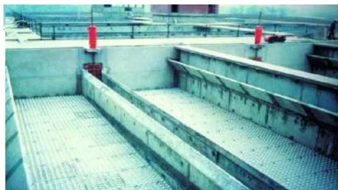
Figure I.3.61: Filtres AQUAZUR Yen cours de construction; vue ester armé, du plancher filtrant avec ses busettes, de la goulotte de balayage en Y et de la goulotte de départ des eaux de lavage.
