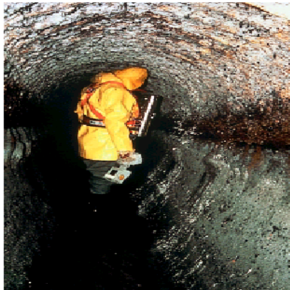
Figure I.28 : Dégradation due à l'attaque de l'acide sulfurique dans une canalisation des eaux usées [22].
