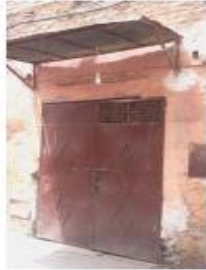
Auvents métalliques inesthétiques
