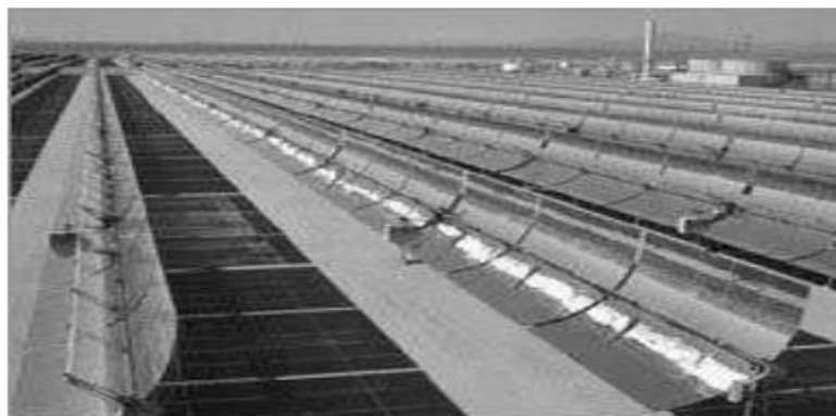
Figure.1.16. La centrale électrique hybride de Hassi Rmel [26]
