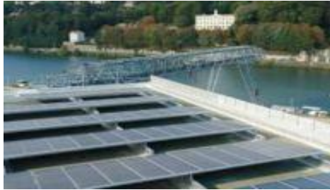
Figure 23: Panneaux solaires de l'îlot aux Bureaux /logements, source : www.lyon-confluence.fr
