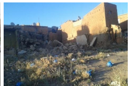
Figure 142: bâti en mauvais état
