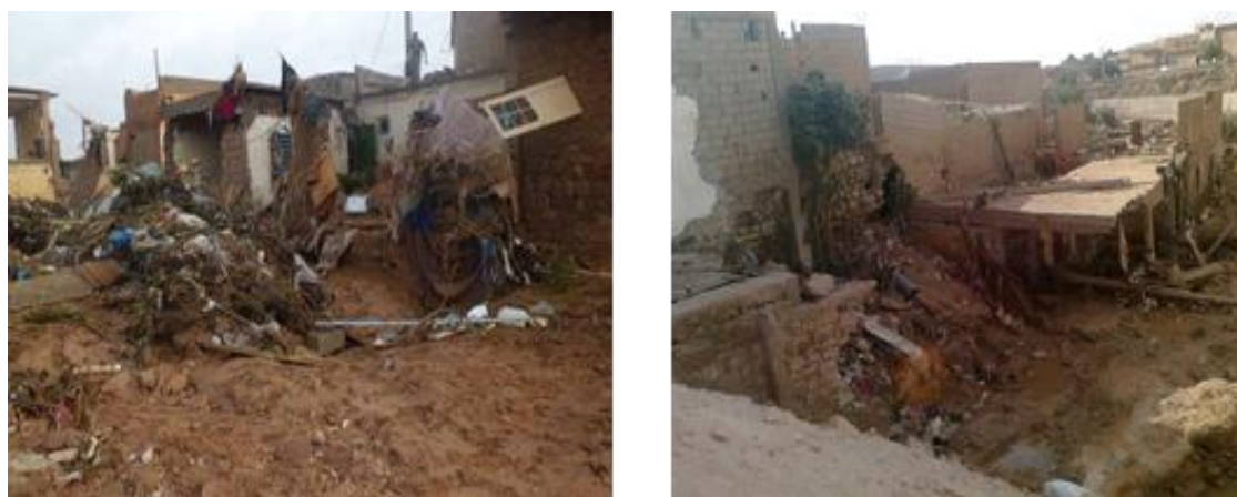
Figure 15: Les constructions dans les berges de l'oued sont à l'état vétuste (quartier Graba )
