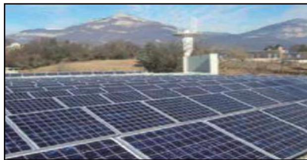
Fig.I-13 Panneaux photovoltaïques [Source : novation écologique, Transformer sa maison au naturel: isoler, restaurer, décorer].
