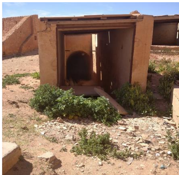
الشكل III_51 : مدخل الممر من جهة البرج الغربي المصدر : من تصوير و اعداد الطالبة
