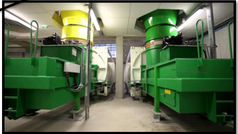
Figure N229: la station de collecte pneumatique /source : auteur
