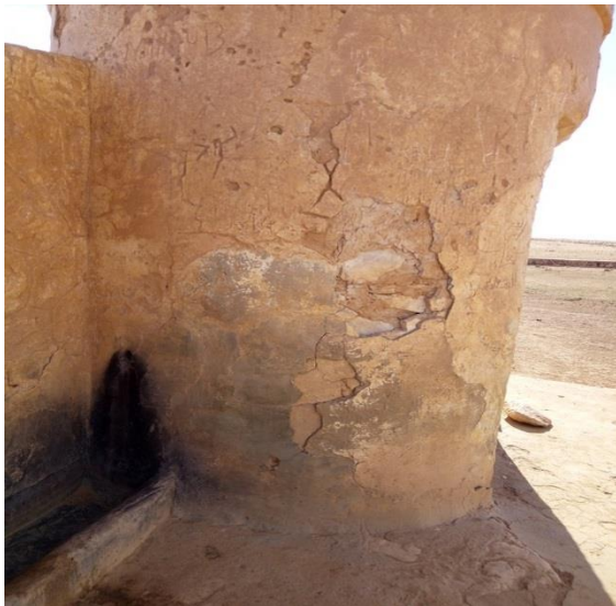
Figure 92 Dégradation des enduit dans le coté gauche de puits
