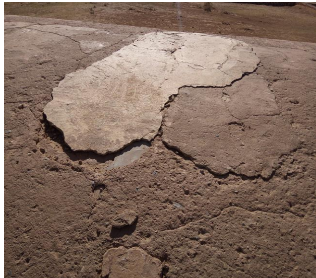
Figure 91 Dégradation des enduit de la voute
