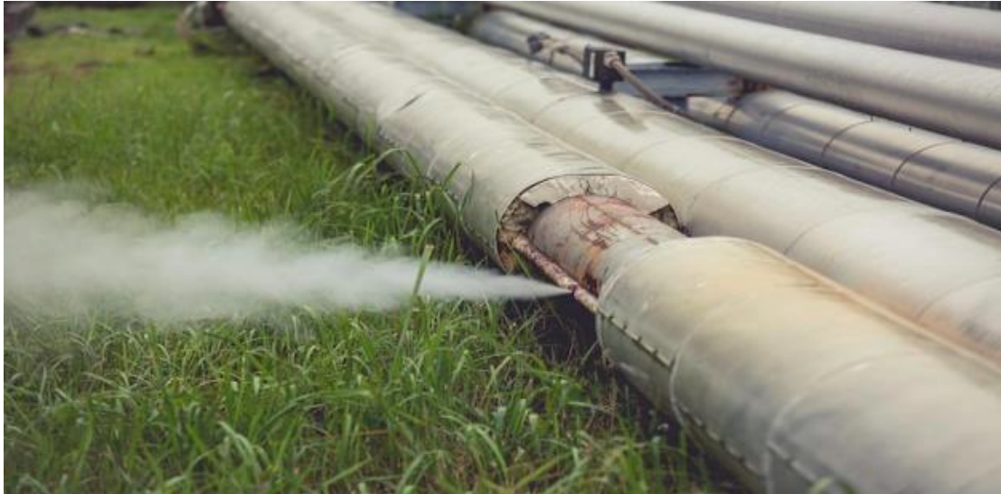
Figure 2.3 : Fuites De Gaz
