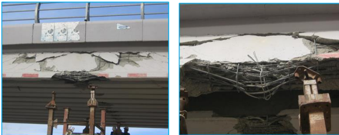
Figure III.4: Destruction des poutres de l'ouvrage
