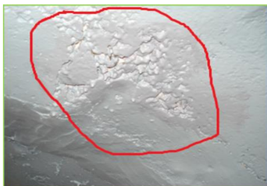
Figure III.18: ségrégation de dalle de la dernière partie première de galerie
