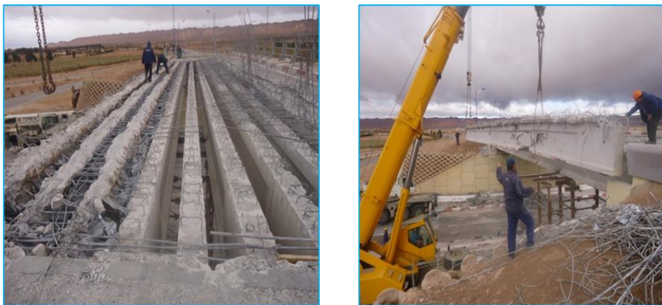
Figure III.8: Enlèvement les poutres endommagées
