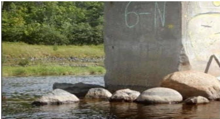
Figure I.13: Fissures de forme polygonale et Zones soumises à l'érosion par abrasion
