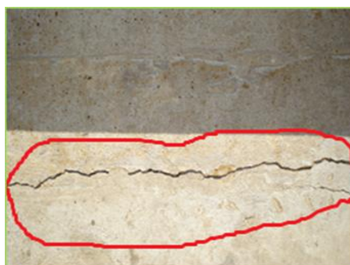
Figure III.22: Fissuration transversale du béton d'une poutre de dalle de galerie
