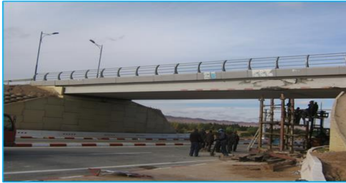
Figure III.3: Vue de l'ouvrage après le heurte de l'engin (Benkhalefa, et al., 2013)
