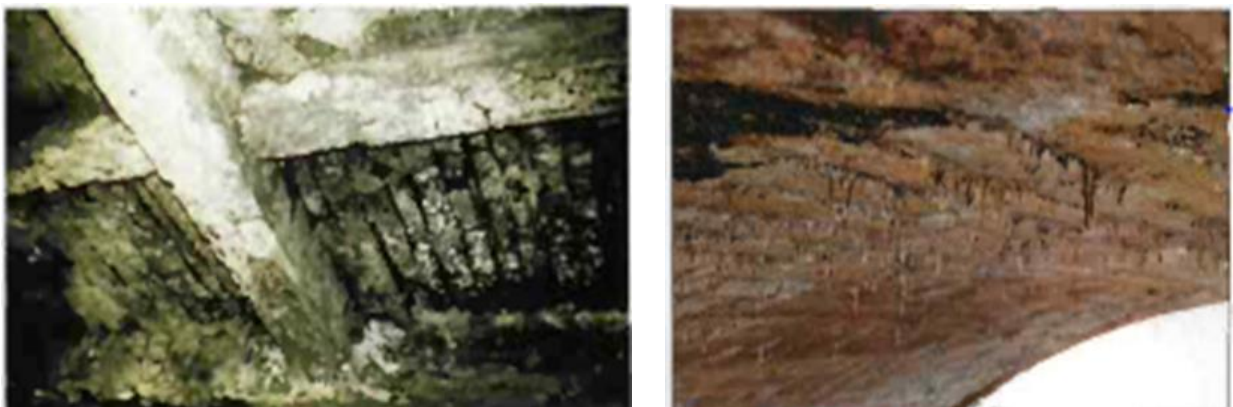
Figure III.1: Etat de l'intrados d'un ouvrage en béton armé sans étanchéité
