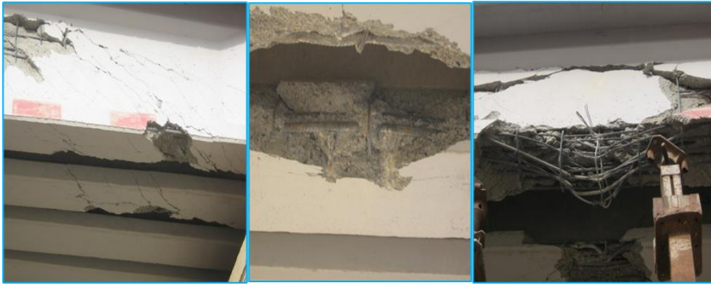
Figure III.7: Eclatement du béton et apparition des aciers et des câbles de précontrainte
