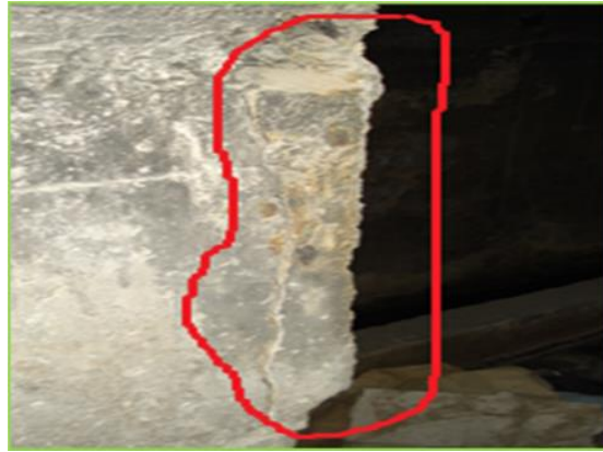
Figure III.23: Fissuration longitudinale d'une paroi de galerie
