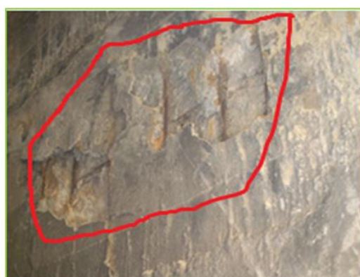
Figure III.15: la corrosion des armatures d'une paroi extérieure de galerie
