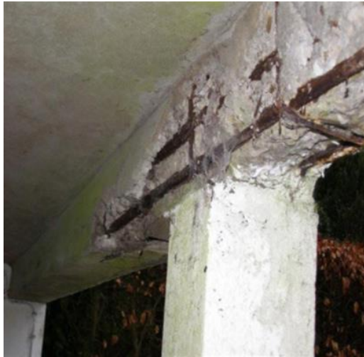
Figure I.12: Corrosion des armatures au sein des constructions en béton armé
