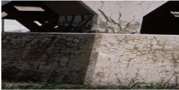
Figure I.6: Fissures de type faïençage sur le pilier d'un pont effectuée par la réaction alcali silice
