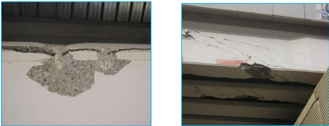
Figure III.6: Discontinuité du béton entre l'âme et le talon supérieur
