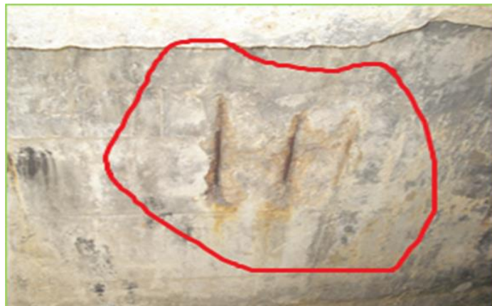
Figure III. 20: L'éclatement du béton d'une paroi de faible d'enrobage d'acier
