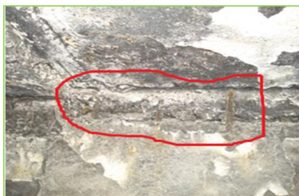
Figure III. 19: Ségrégation de dalle de la partie de galerie
