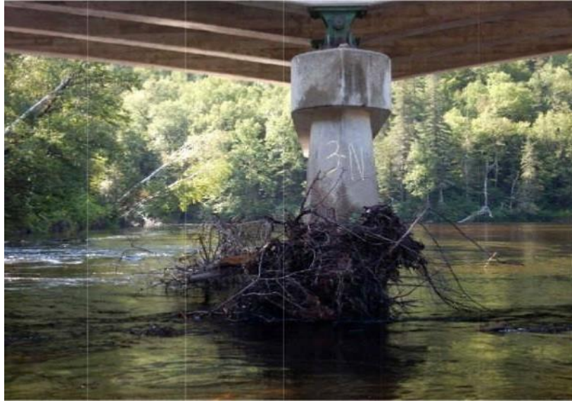
Figure I. 14: Abrasion visible sur des fondations du pont
