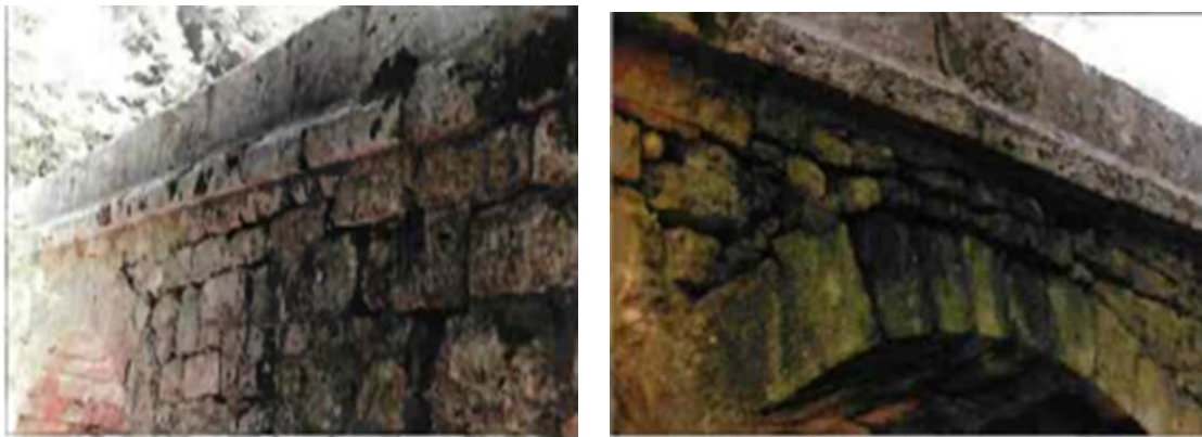
Figure III.2: Dissolution du mortier de jointoiement avec déplacement des moellons
