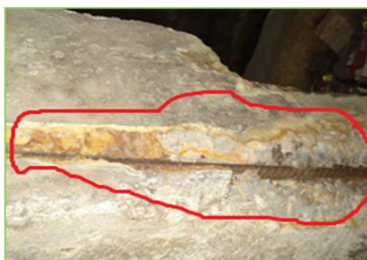
Figure III.16: la corrosion des armatures et l'éclatement du béton d'une paroi
