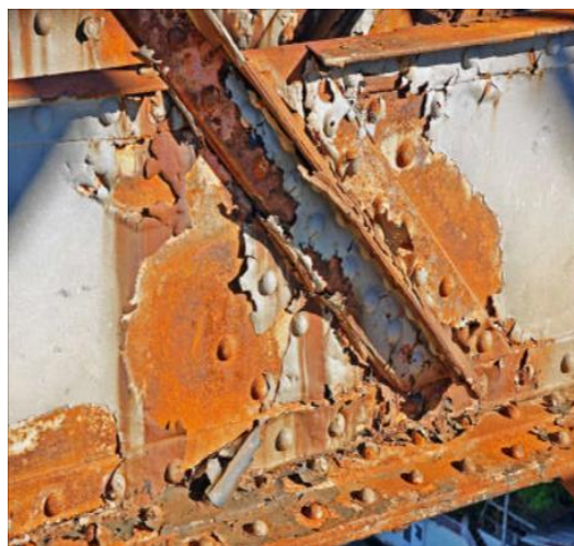
Figure I.11: Corrosion atmosphérique des structures Métalliques
