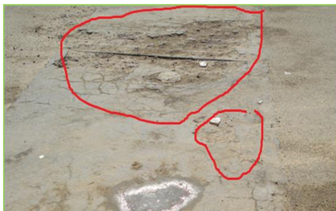
Figure III.21: Les dégradations des faces extérieures des dalles de galerie
