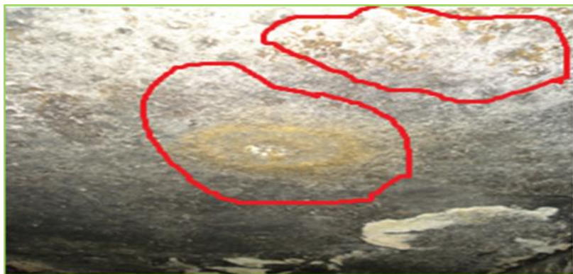
Figure III.17: La Corrosion des armatures et la fissuration du béton a la dalle
