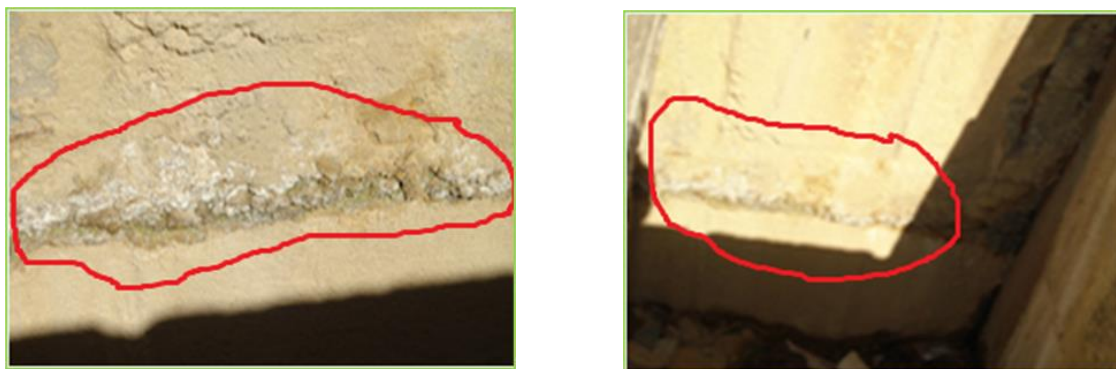
Figure III.14: La Carbonatation des parois du regard de galerie
