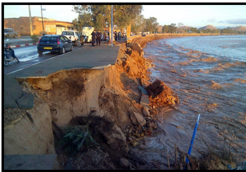
Photo 04 : dégâts de la crue du 30 septembre 2016
