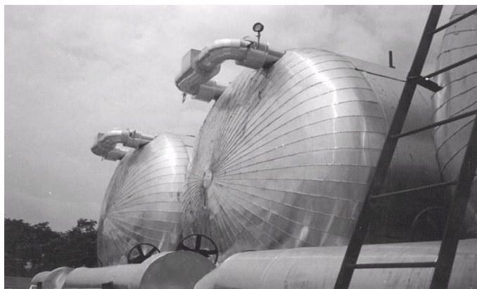
Figure 1.3: Réservoirs d'un système de stockage installée à Tidel Park, Inde [7].
