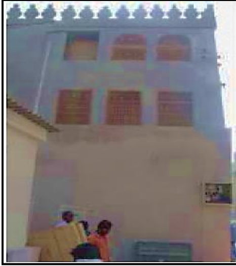
شكل 33: مظهر الشرخ في الواجهة الشمالية بعد العلاج المصدر: المرجع السابق
