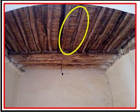
شكل 119: صورة توضح العوارض الخشبية المصدر : الطالبات
