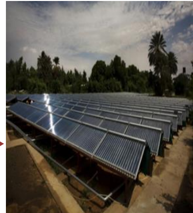
Figure 56 la ferme des panneaux solaire de centre Salam
