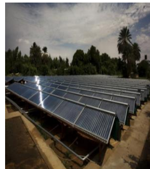
Figure 22: panneaux solaires source : archidaily
