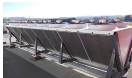
Figure 45: Installations nettoyables en place source : www.thermebalaruc.fr
