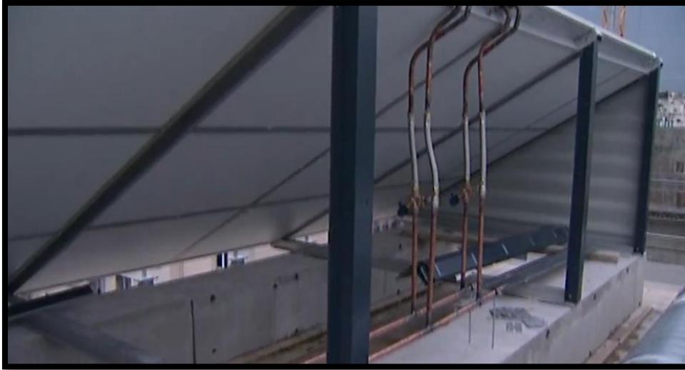
Figure.34: les panneaux solaires
