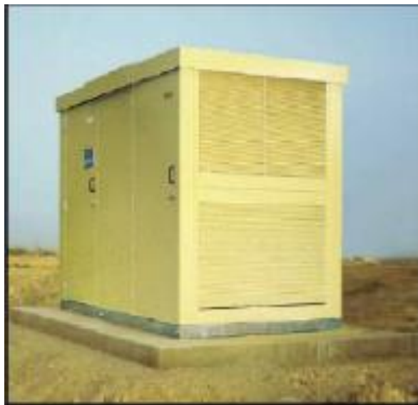
Figure I-2 : Poste préfabriqué MT/BT.
