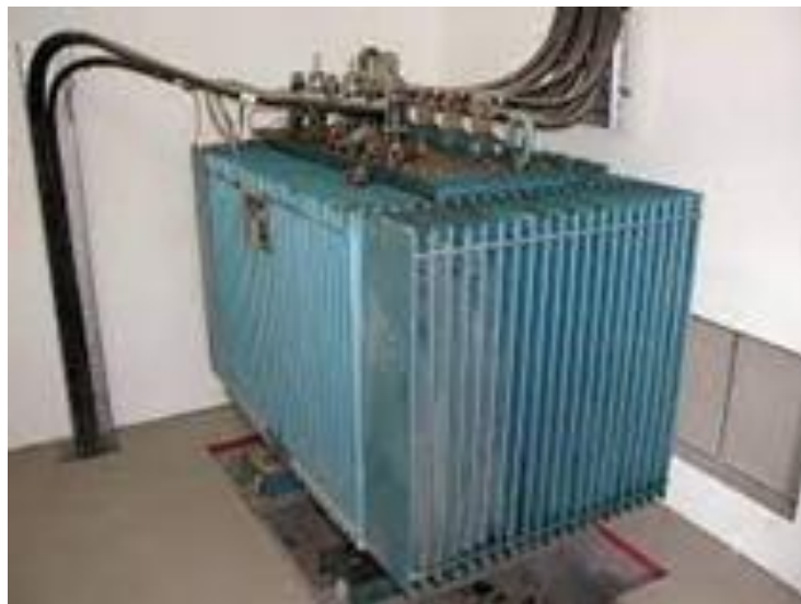
Figure II-5: Transformateurs de puissance MT/BT.
