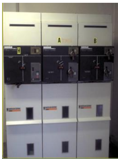
Figure I-12: équipement GIS blindés.
