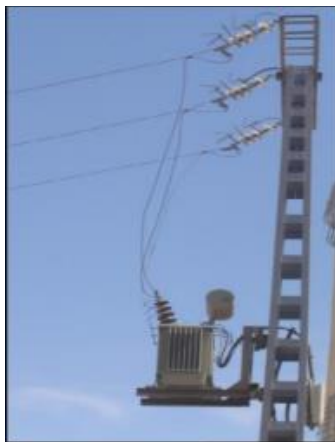
Figure I-1: Poste MT/BT sur poteau (ACC).
