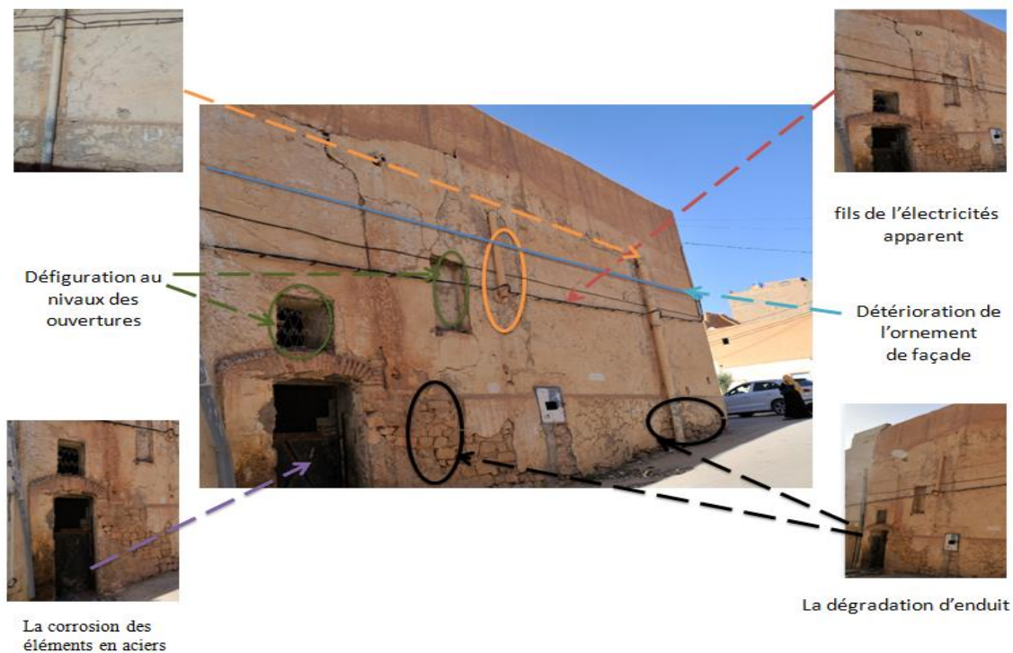
Figure. III.31. Les pathologies de la façade postérieure de hammam El- Saada Source : auteur.
