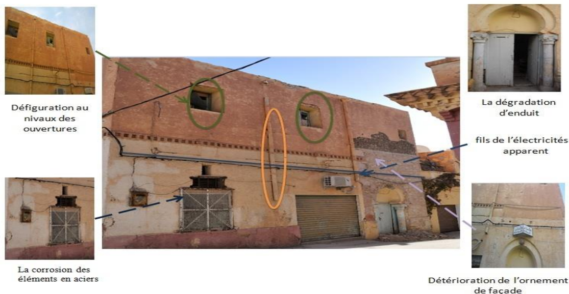
Figure. III.29. Les pathologies de la façade principale de hammam El- Saada
