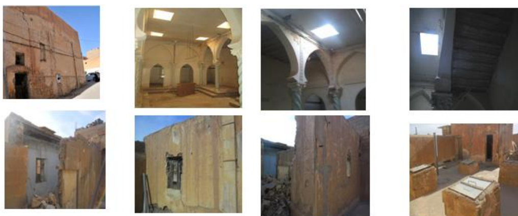
Photo. III.17. Les espaces qui nécessitent des travaux d'urgence Source : auteur.
