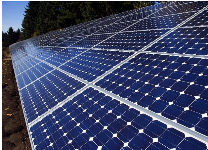
Figure 121 : des panneaux photovoltaïques
