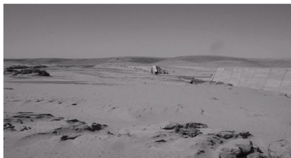
Fig.4.3. Dégradation de digue Lahdhira en 2008
