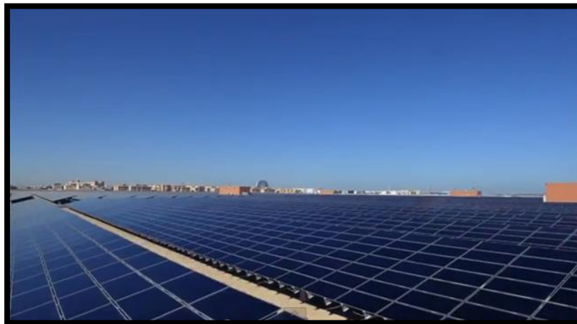
Fig. 51 : les panneaux photovoltaïques. Source : https://webdeveloppementdurable.com/dossier-masdar-loasis-verte-au-pays-de-lor-noir/3/
