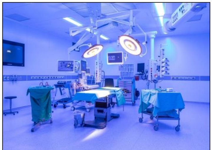
Figure 137 schéma fonctionnelle de bloc opératoire, source : guide d'aménagement, bloc opératoire Préparé par : Direction de l'expertise technique, p : 4.
