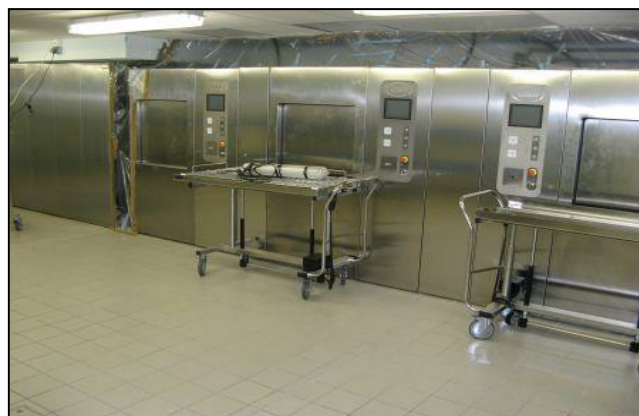
Figure 164 : autoclave stérilisation : www.sante.gouv.fr/fonctionnement interne à l'hôpital/guide de recommandations
