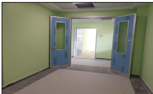
Figure 235: revêtement sol dur en grès Céram à la circulation
