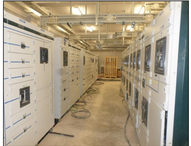
Figure 223 : Photo de TGBT hôpital 240 lits. Laghouat
