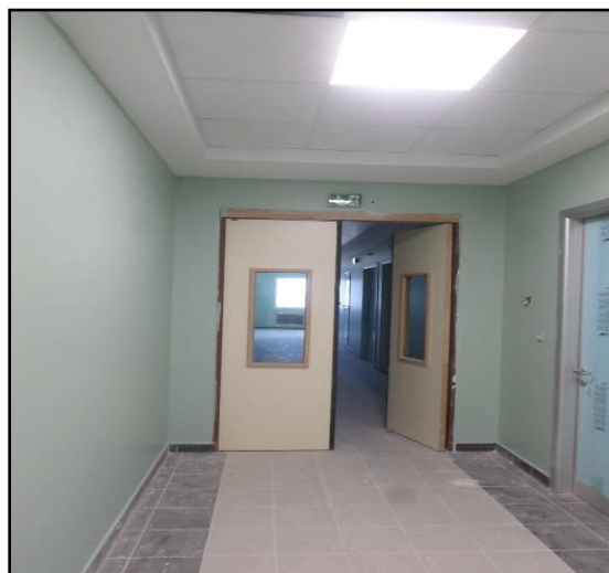
Figure 245 : Les portes coupe-feu Hôpital 240 lits. Laghouat Source : auteur
