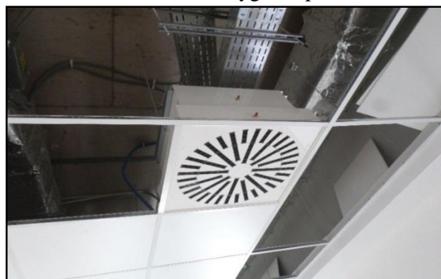
Figure 232 : faux plafond fixe en plaque de plâtre avec des trappes de visite 240 lits à Laghouat
