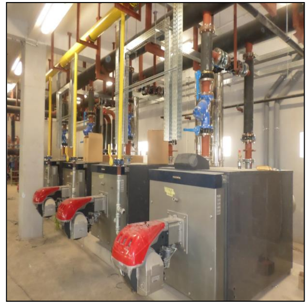
Figure 220: local chaudière- group eau glacé 240 lits. Laghouat source : auteur
