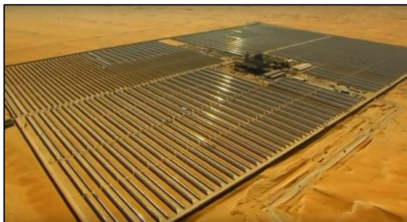
Photo 31 centrale photovoltaïque de 10 MW
