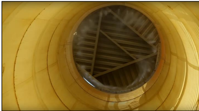
Photo 29 brumisateurs dans la tour à vent
