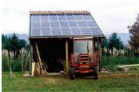
Photo18 :Exemple d'installation des panneaux photovoltaïques sur une dépendance
