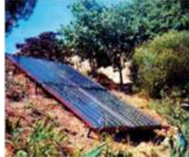
Photo17 :Exemple d'installation des panneaux photovoltaïques au sol
