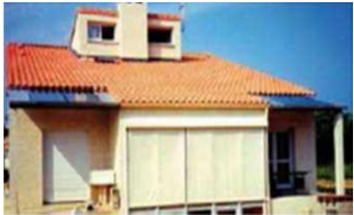
Photo12 :Intégration des panneaux photovoltaïques en auvent et brise soleil sur ouvertures
