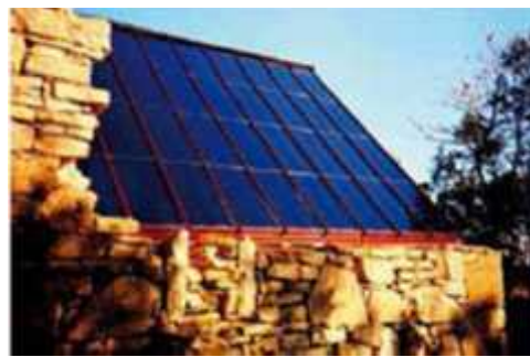
Photo19 :Exemple d'installation des panneaux photovoltaïques sur une dépendance
