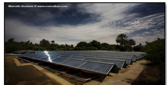
Figure 61 : panneaux solaires source : archidaily.com
