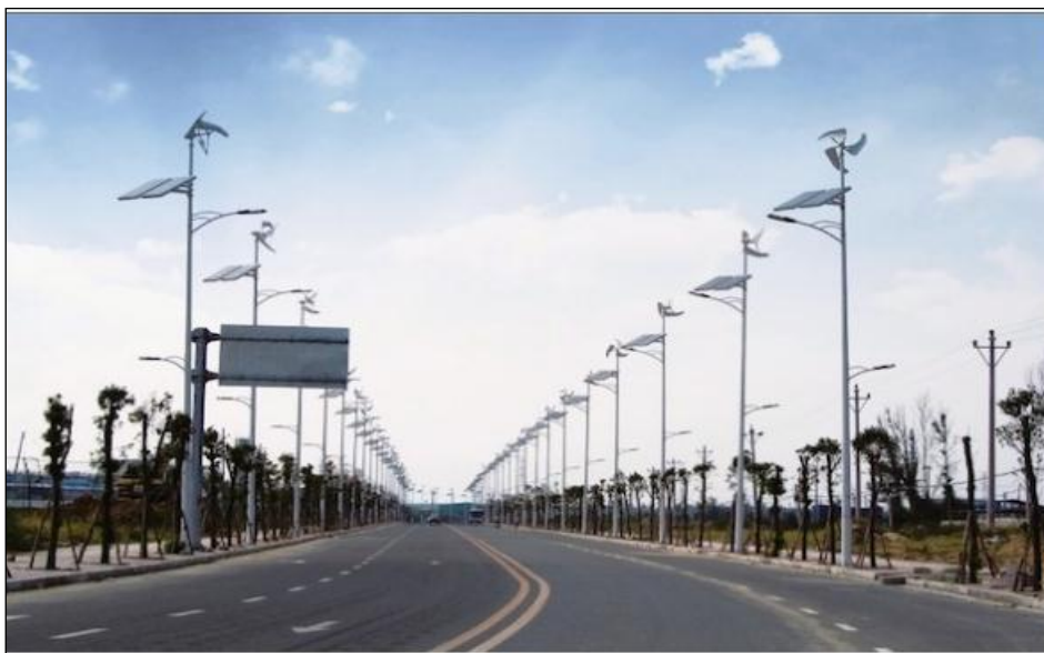
Figure 26 : Des lampadaires à vent et photovoltaïques
