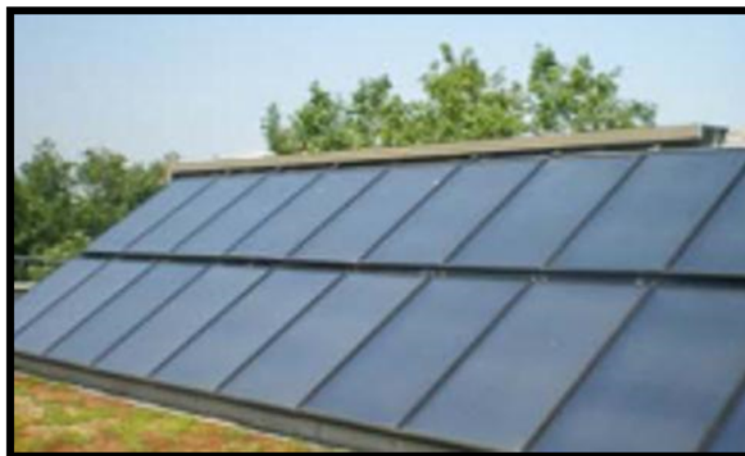
Figure 47 : Panneaux solaires du collège
