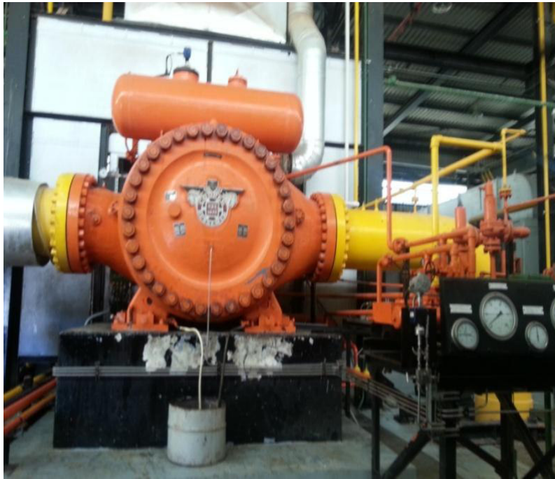
Figure 4.01. Compresseur centrifuge Cooper-Bessemer.
