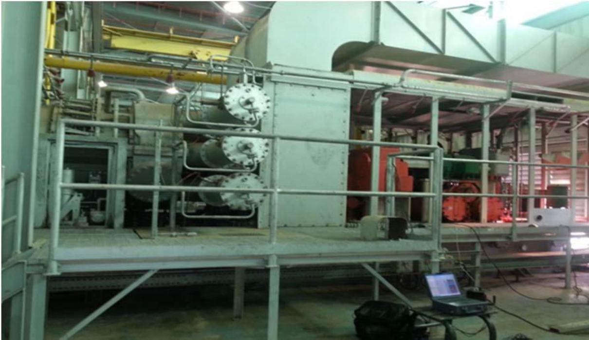
Figure 4.48 Turbine à gaz de la marque GE MS3002.
