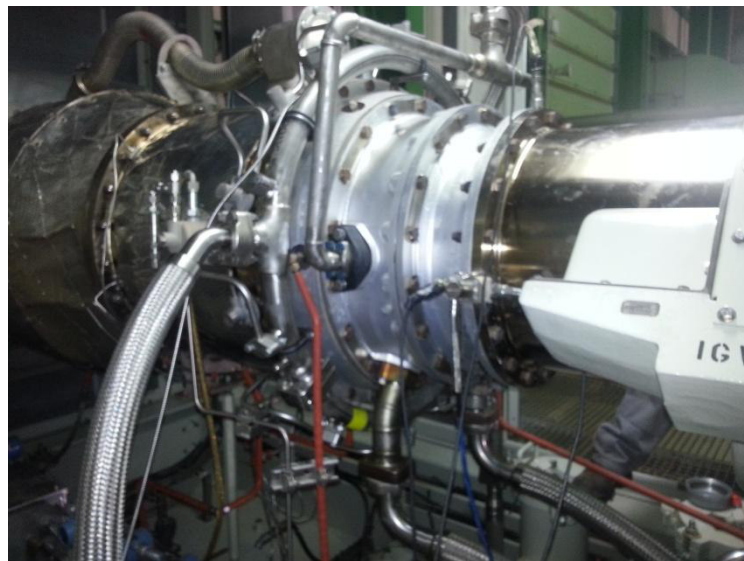
Figure 4.35 Turbine à gaz (Solar Centaur 40).
