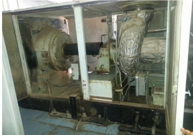
Figure 4.18. Turbine à gaz Solar Saturn 10.
