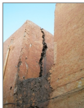
Photo 11 : Les fissures. Source : l'auteur.
