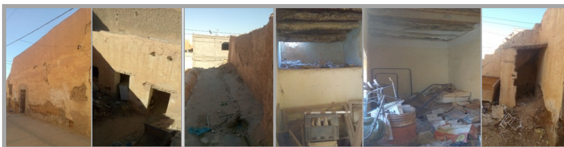
Photo N°26 : Maison en ruine sur l'axe d'intervention. /Source : Elaborer par l'étudiante.
