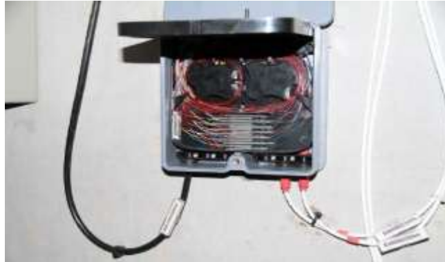
Figure II.17 : Boîtier pied Immeuble.
