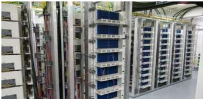
Figure II.15 : Nœud de raccordement optique.
