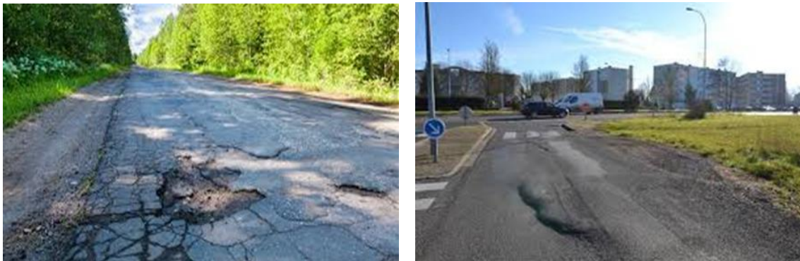
Figure 1.1. Dégradation des chaussées souples.
