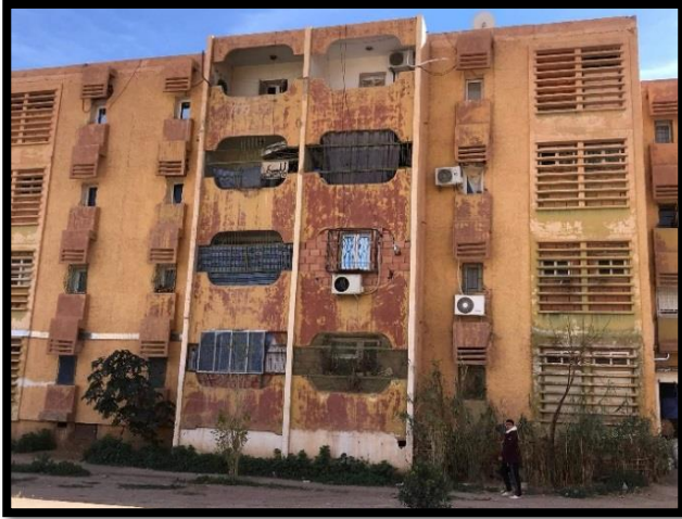
Figure IV-5 Une façade dégradée Source : prise par l'auteur
