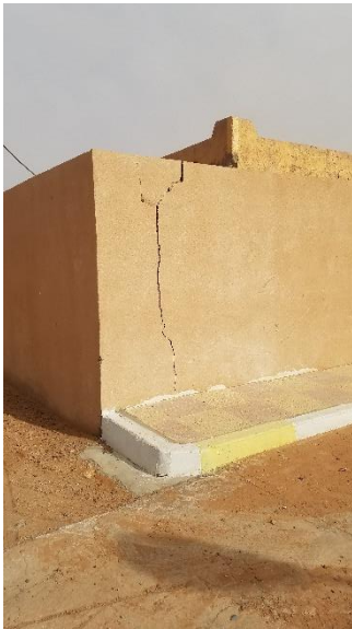
Figure III-6: Fissure verticale au niveau d'une clôture en parpaing.
