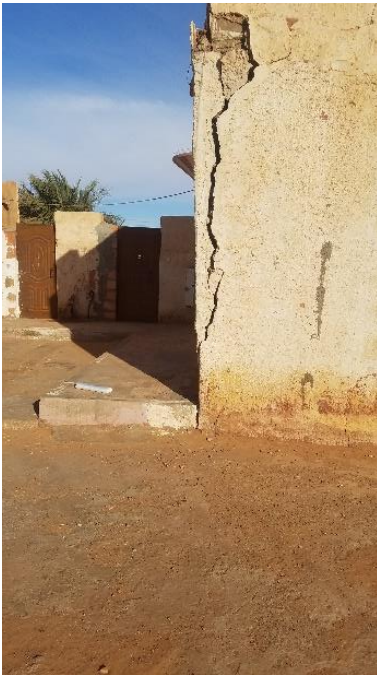
Figure III-5 : Fissure vertical au niveau du poteau de rive.
