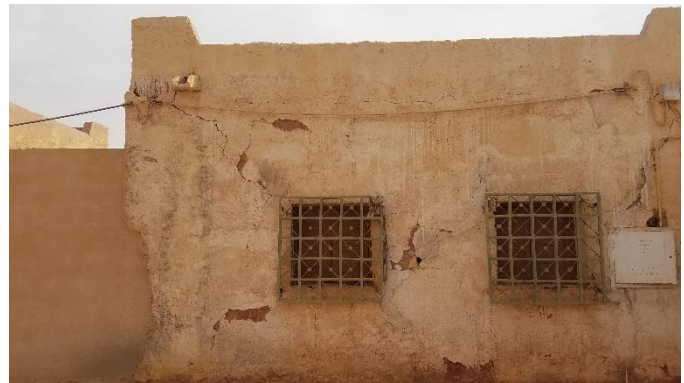
Figure III-7: Fissure inclinée entre le poteau de rive et les fenêtres plus décollement de l'enduit sur le mur
