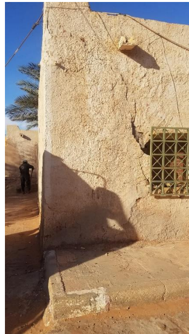
Figure III-4: Fissure incliné entre le poteau de rive et la fenêtre.
