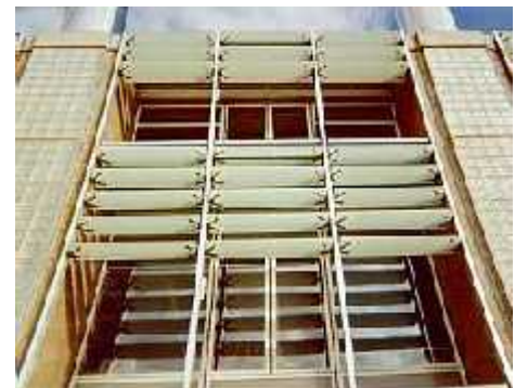
Figure I.32 : les stores extérieurs de BRE. Source : Energie plo.e.lesite.be
