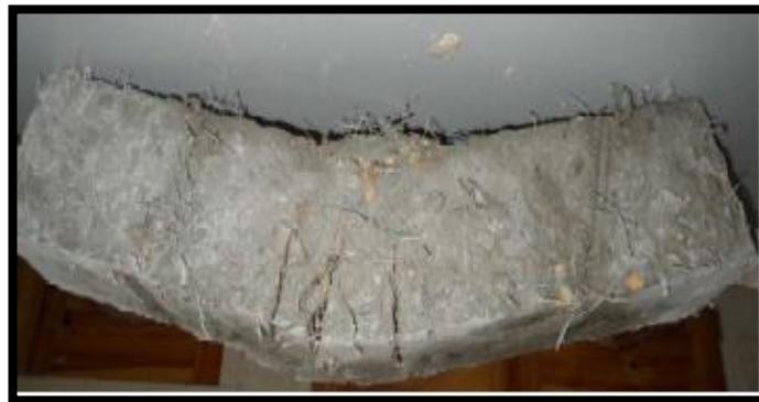
Figure I.29: Poutre en B0.50 sans ferrailage transversal. (Bendjillali et Chemrouk, 2018)
