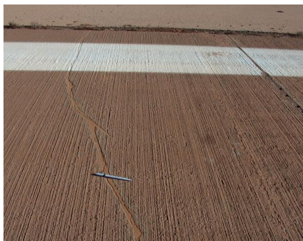
Figure 67 : Fissure transversale qui traverse toute la largeur de la dalle.
