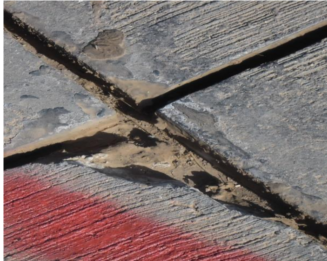
Figure 68 : Cassures d'angle en coin de dalle dans la piste principale.
