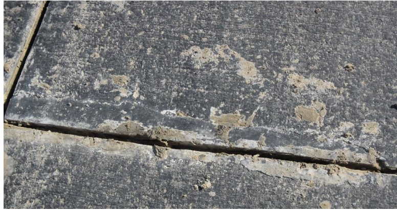
Figure 70 : Joint entre dalles en mauvais état.
