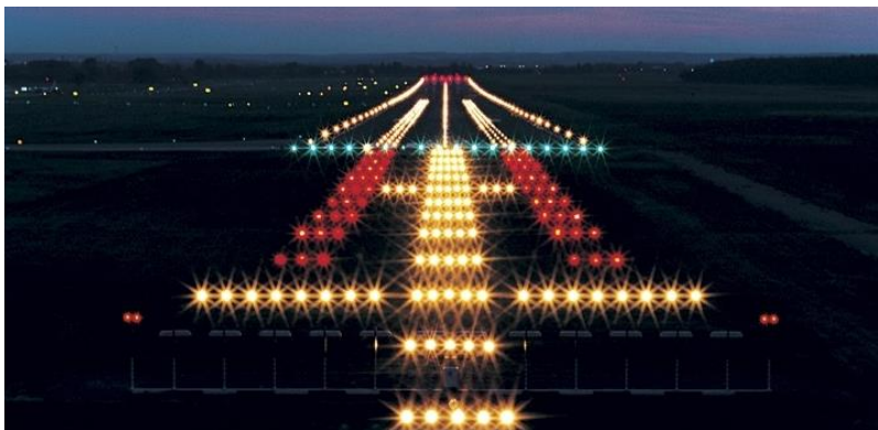
Figure 9 : Balises lumineuses d'une piste d'atterrissage.
