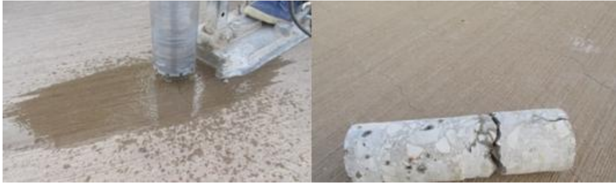
Figure 38 : Cette carotte montre que la fissure est superficielle (environ 06cm).
