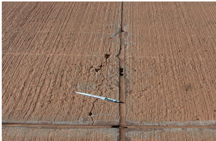
Figure 69 : fissuration en coin de dalle dans la piste principale.
