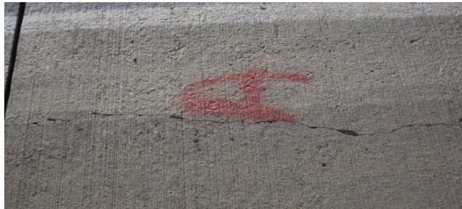
Figure 66 : Fissure longitudinale parallèle à l'axe de piste.
