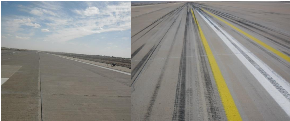
Figure 22 : Relevé visuel des dégradations.
