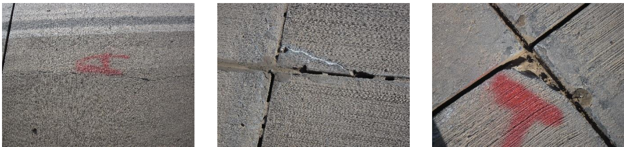
Figure 34 : Les dégradations enregistrées sur la piste principale.
