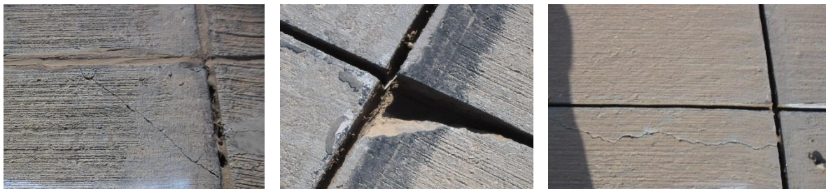
Figure 36 : Dégradations relevées visuellement (la piste principale 16L/34R).
