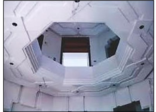
Figure 10: faux plafond en plâtre. Source : Hygiène hospitalière —confinement des poussières lors des travaux.
