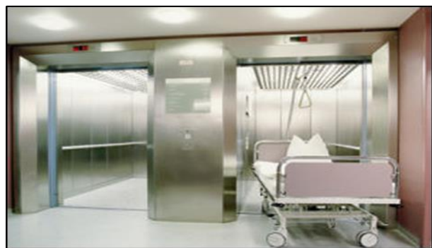
Figure 27:Ascenseur dans un hôpital.
