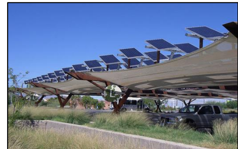
Figure 26:parking couvert avec panneaux solaire.
